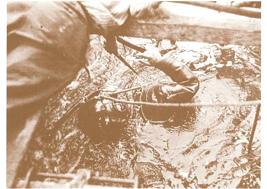
Anno 1957-Casalmaggiore (CR). Riparazione della fondazione del II° pilone del ponte ferroviario sul Po (linea Parma-San Zeno). Il palombaro Zanaboni è in acqua e si sta preparando alla discesa guidata. Nel Po i palombari lavoravano sempre in mezzo ai rifiuti galleggianti ed ai detriti trasportati dalle acque limacciose.
